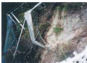
従来型の支柱に落石が衝突した場合。支柱が損傷。
