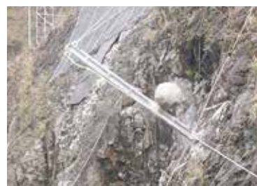
オープンロックネットの支柱に落石が衝突した場合。支柱の損傷なし。
